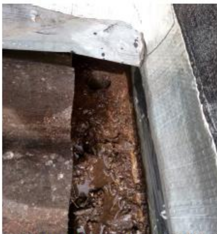
Foto 3: Sujeira acumulada em toda a calha da edificação.
