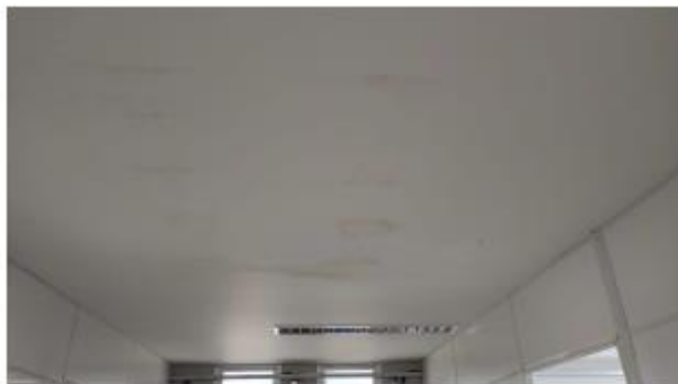
Foto 7: Forro manchado ( ambiente insalubre)
