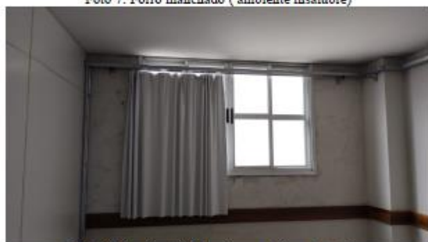
Foto 8: Parede c/ infiltrações em toda a extensão.
