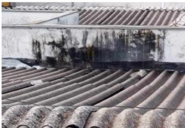
Foto 2: Ausência de Manta nas calhas.
