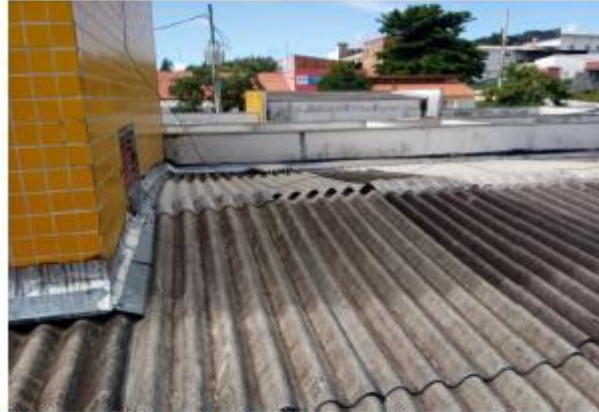
Foto 4: Visão geral da área crítica da cobertura com telhas emendadas, engradamento flambado ao centro prejudicando sua inclinação e conseqüente acúmulo de água favorecendo infiltrações na laje e forro.
